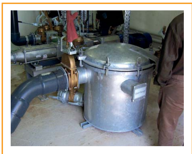
Figura 3.5: Separador de materiais pesados em tubulação [DBFZ]
