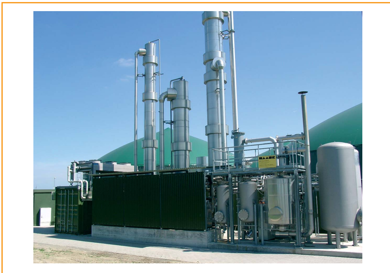
Figura 6.3: Estação de tratamento de biogás (lavagem Genosorb) em Ronnenberg [Urban, Fraunhofer UMSICHT]
