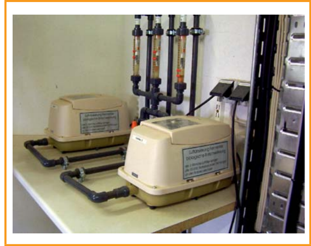
Figura 6.1: Controle de gás para sopramento de ar no gasômetro do biodigestor [DBFZ]
