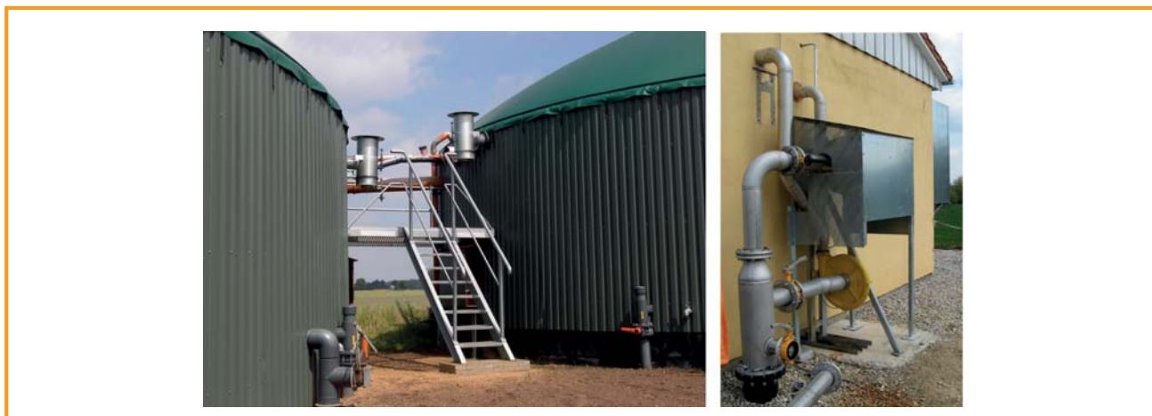
Figura 3.21: Plataforma de trabalho entre dois reservatórios com tubulação e dispositivos de alívio de pressão (esquerda); tubulação de gás com soprador compressor (direita) [MT-Energie GmbH (esquerda), DBFZ (direita)]
