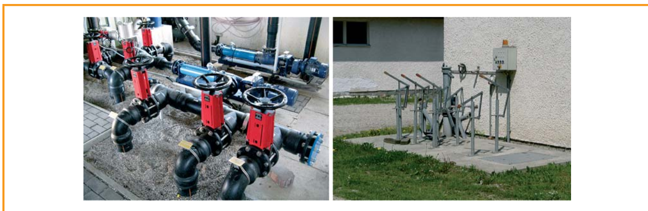
Figura 3.20: Tubulações e válvulas em uma estação de bombeamento, válvulas de gaveta [DBFZ]
